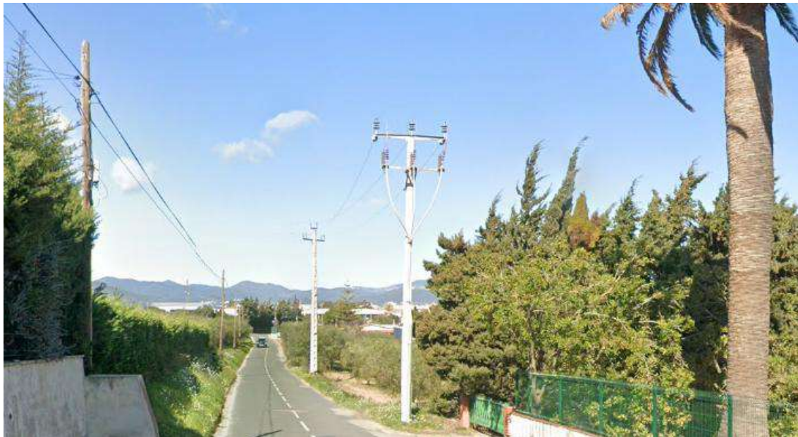
Imatge 4. Torre elèctrica al camí de Sant Joan. Font: Google Earth.
